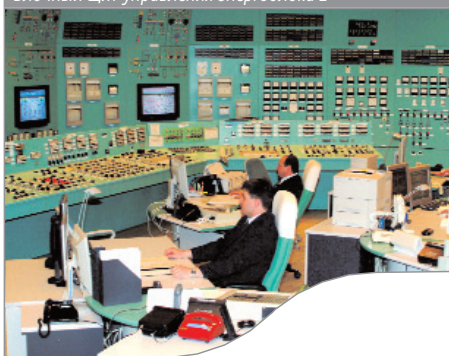
Блочный щит управления энергоблока 2
