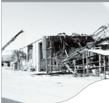
Разрушения, вызванные ураганом во Флориде
